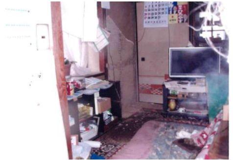
被害状況①左側の土壁崩壊
