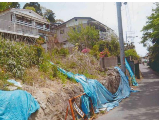
住宅に隣接した崖崩れ現場
