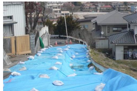
(大きな被害を受けた緑ヶ丘地区)
